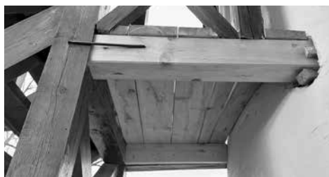
Bašta "A" (provizorní vyspravení podesty vstupu do patra).
